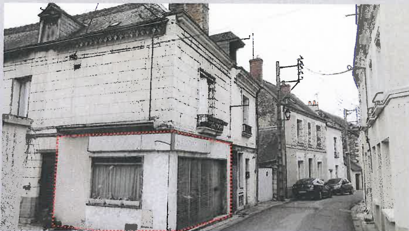
Autre exemple d'éventrement d'un rez de chaussée déséquilibrant la composition de la façade et dénaturant le chaînage d'angle en pierre de taille.
