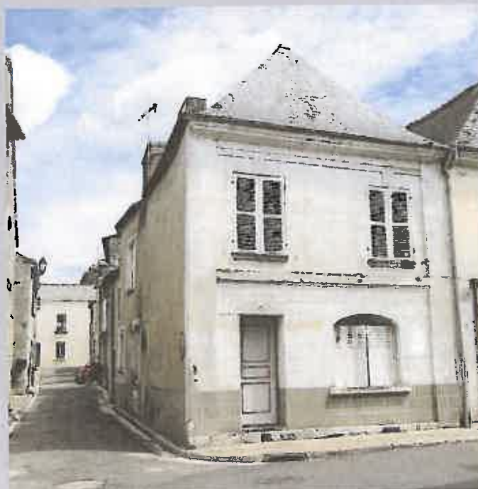
Façade sur laquelle il n'est pas envisageable d'apposer une isolation par l'extérieur présence de modénatures de pierre, (appui de fenêtre, bandeau d'étage, corniche)
