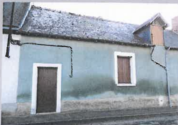
Enduit ciment entraînant des problèmes d'humidité
