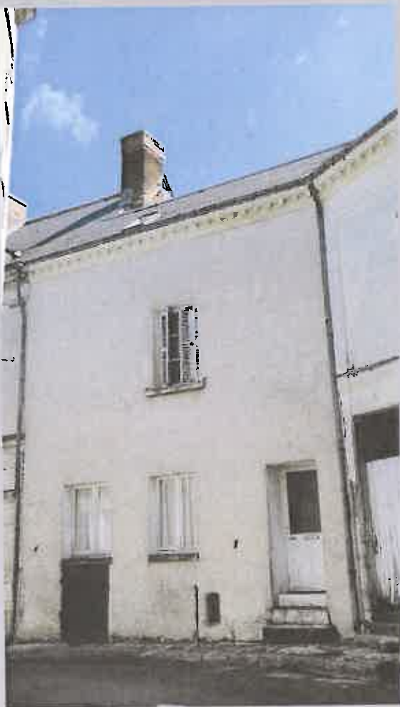
Façade dont les modénatures ont disparues suite au ravalement
